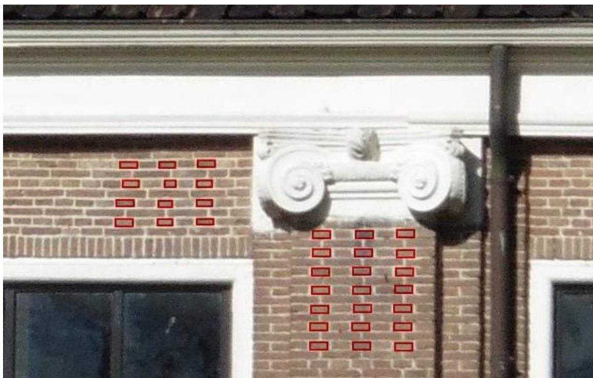
17. Foto van voor de restauratie. Het tamelijk slordige metselwerk van de vlakken boven, tussen en onder de vensters wijkt sterk af van de strak gemetselde originele gevelonderdelen – in dit geval een van de pilasters (in staand verband). Hier is overduidelijk een andere metselaar aan het werk geweest. Let op de verspringingen in de gevel bij de regenpijp. Daarvan is alleen de eerste oorspronkelijk.
