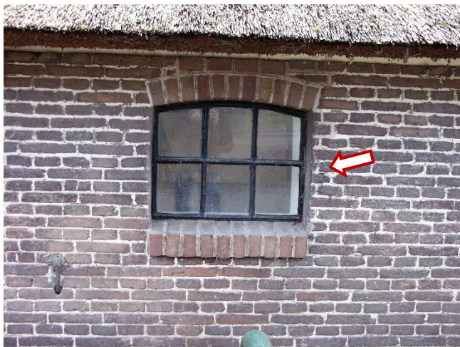
41. Hakwerk in de gevel laat zien dat dit gietijzeren stalraam later is geplaatst.
